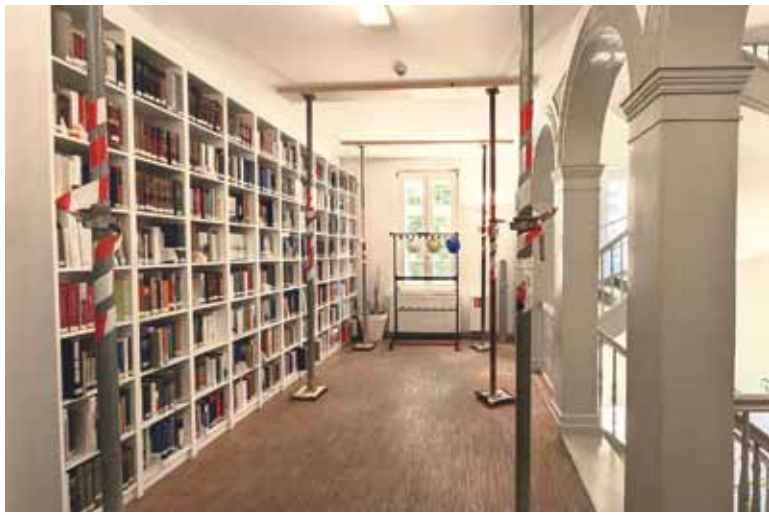
Nachdem im Historischen Bahnhof in einer abgehangten Decke ein Schaden aufgetreten war, wurden im 1. Stock zur Sicherung Stützen aufgestellt.
